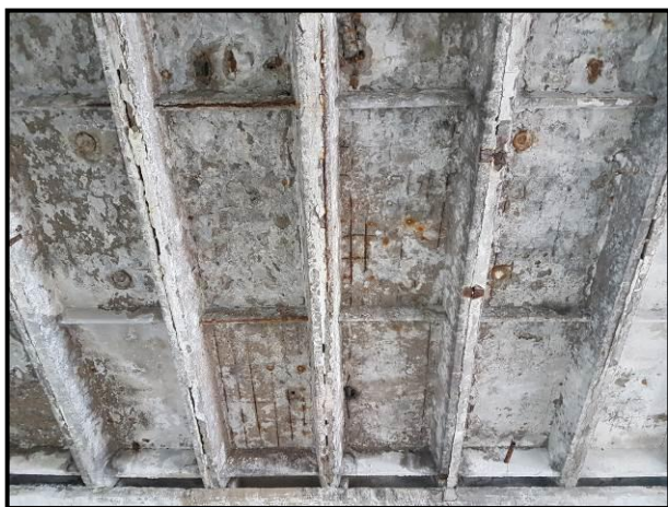
Рис. 3. Следы коррозии плит перекрытия
