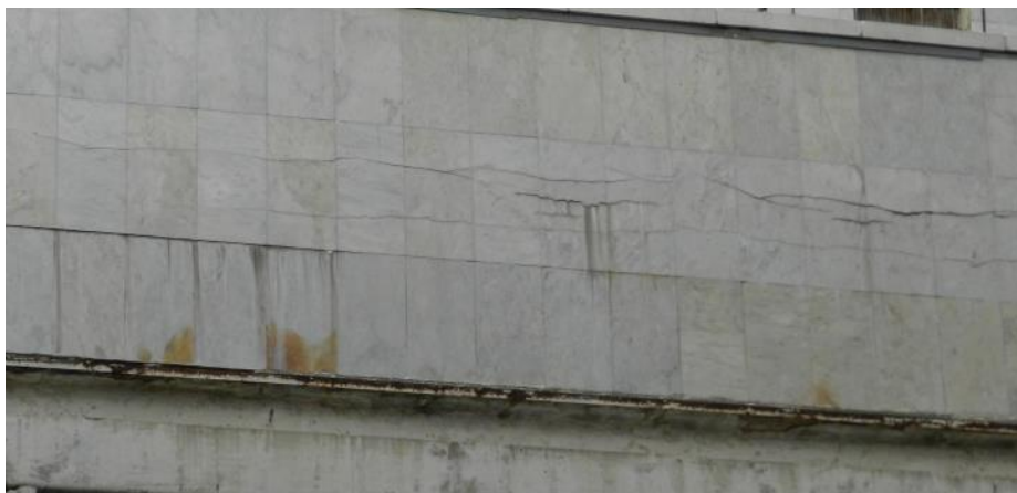
Рис. 5. Выпучивание мраморных плит
