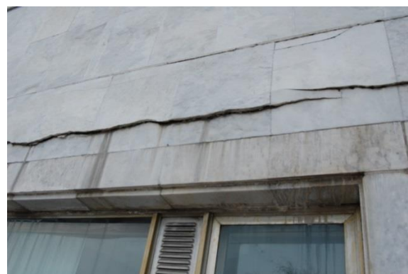
Рис. 2. Характерные дефекты фасадного покрытия
